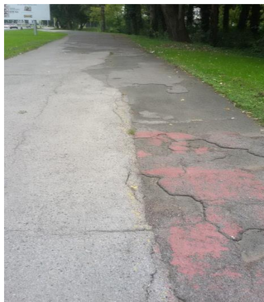
Slika 35. Oštećenje biciklističke staze Izvor: [15]
