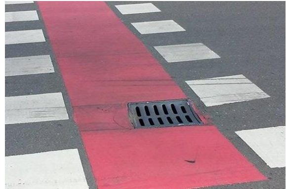
Slika 18. Nepropisno postavljene slivne rešetke na Aveniji Dubrovnik
