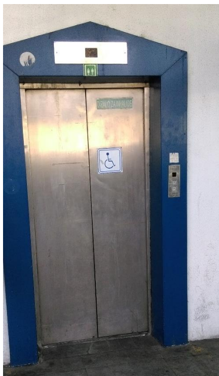
Slika 6.1. Postojeće i jedino dizalo za osobe s invaliditetom kod dolaznih perona
