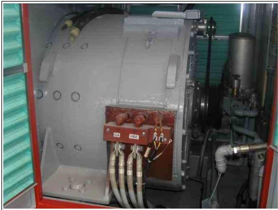
Slika 16. Glavni generator nakon rekonstrukcije
