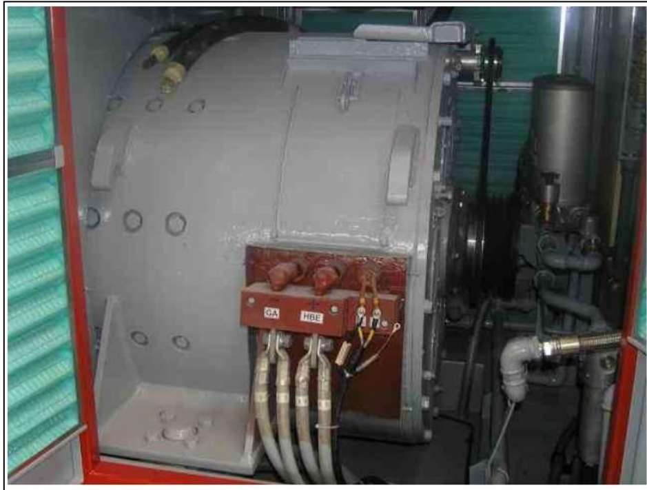
Slika 16. Glavni generator nakon rekonstrukcije
