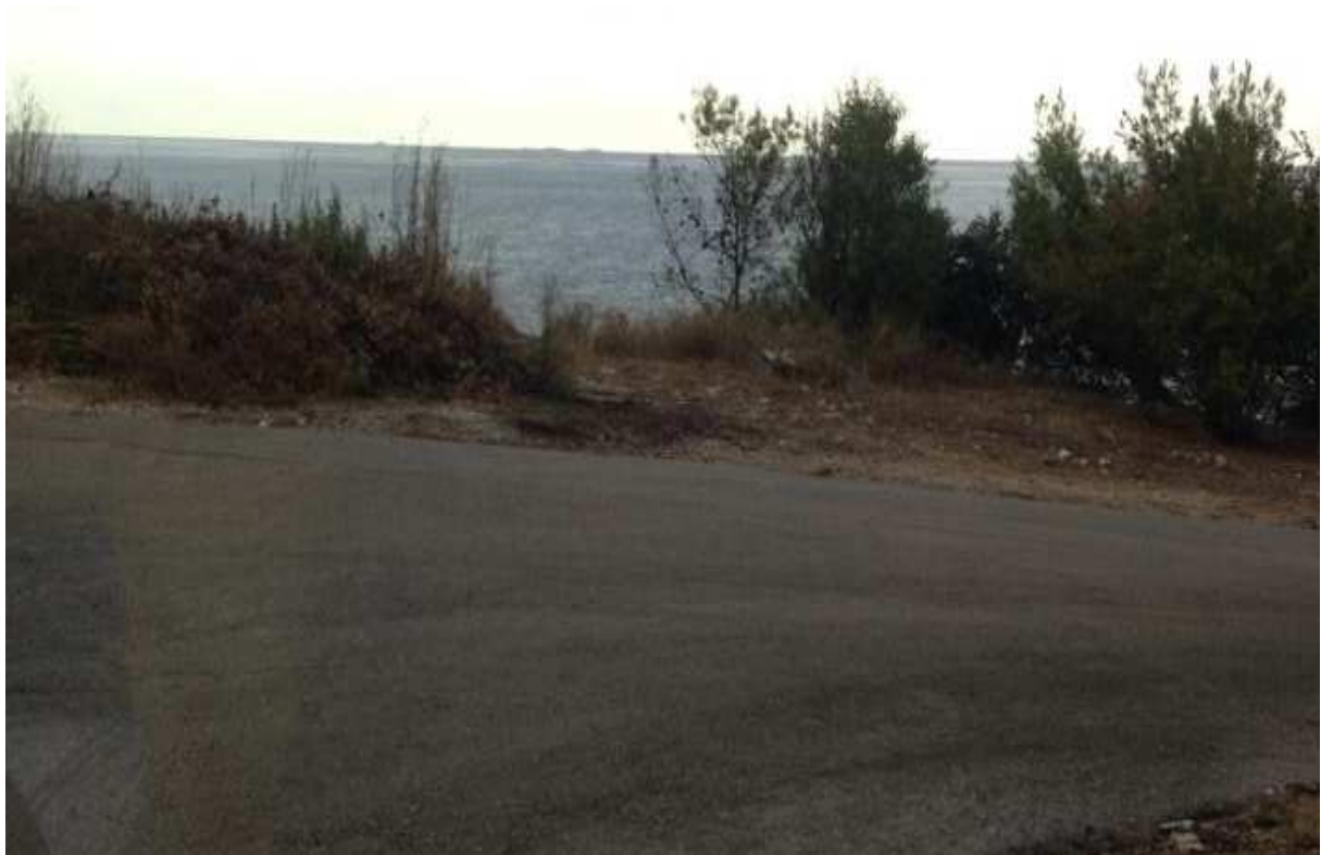
Slika 14. Istrošeni asfalt na dionici Čara-Smokvica
