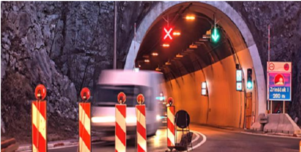
Slika 12. Signalizacija u tunelu
