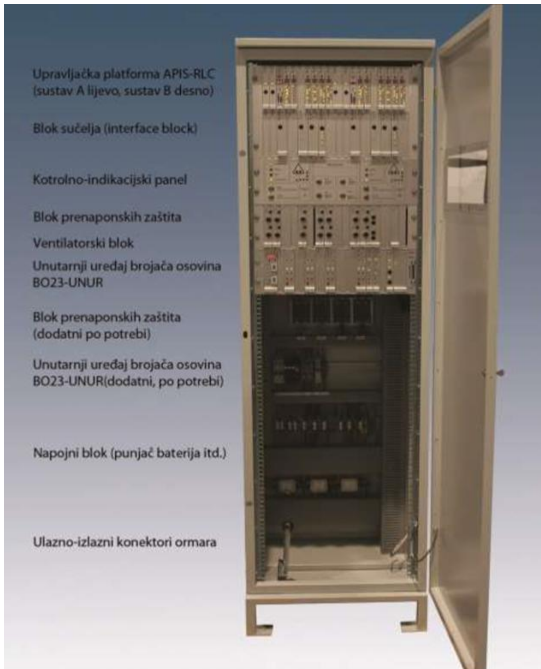
Slika 3. Smještaj opreme na upravljačkom ormaru ŽCPR-a RLC23 [2].
