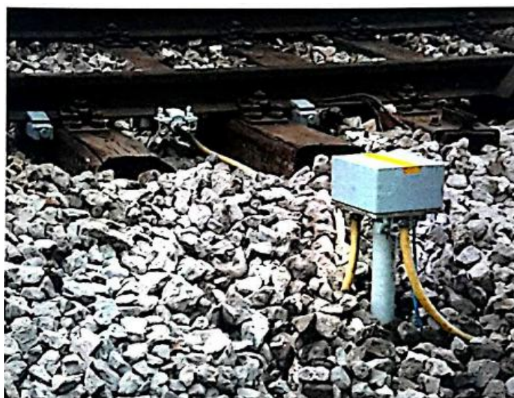
Slika 24. Kontrolni elektronički sklop vanjskog uređaja VUR u kutiji uz kolosijek (Altrpro) [2].
