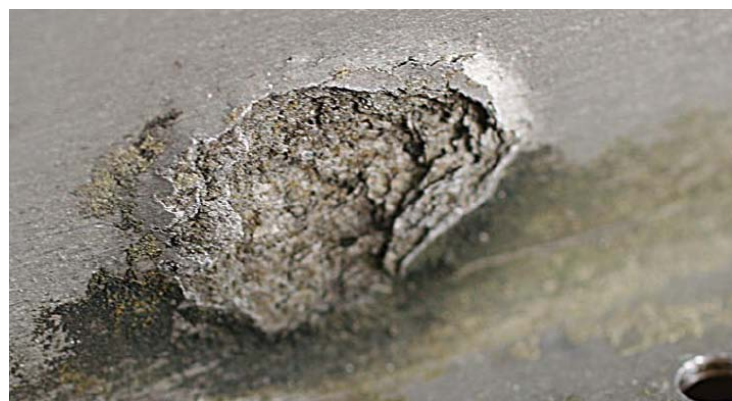
Slika 4. Delaminacija uzrokovana korozijom [9]
