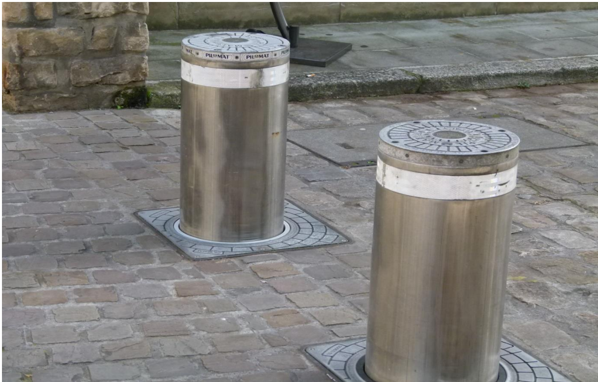
Slika 13. Automatizirani zaštitni stupovi u Madridu
