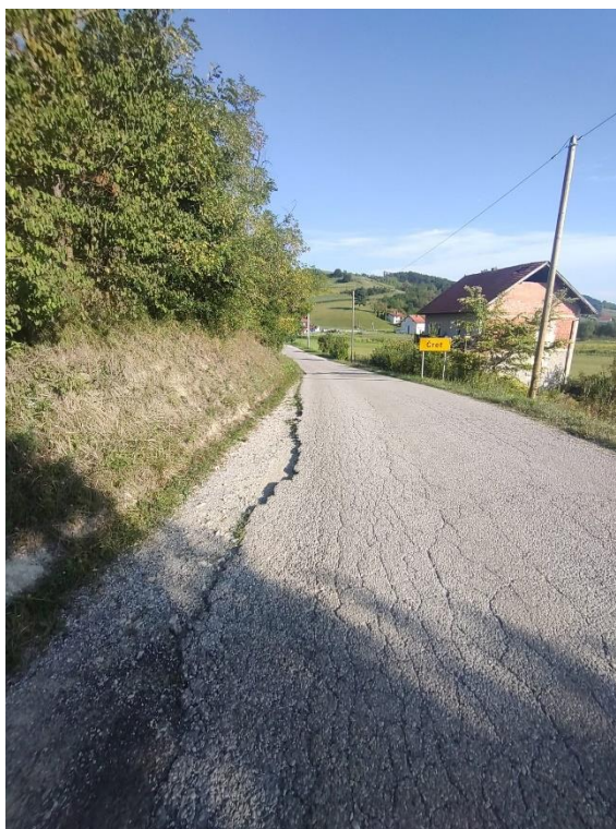
Slika 11: Oštećenje ruba kolnika na lokalnoj cesti LC22082 (Čret)
