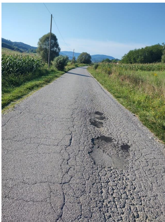
Slika 12: Udarne rupe i pukotine zastora na lokalnoj cesti LC22082 (Čret)
