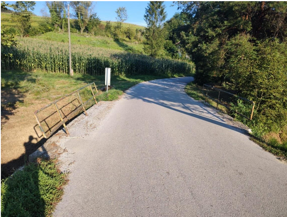
Slika 8: Stanje ograde mosta na županijskoj cesti ŽC2119 (Mala Erpenja)
