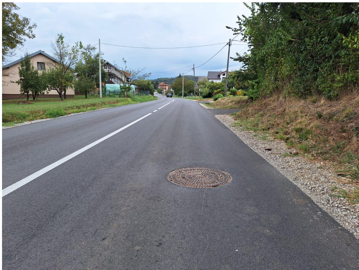
Slika 17 Primjer neadekvatno postavljenih šahtova na ŽC 3185
