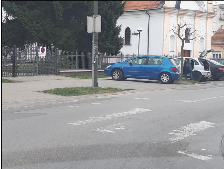
Slika 18. Istrošeni pješački prijelaz
