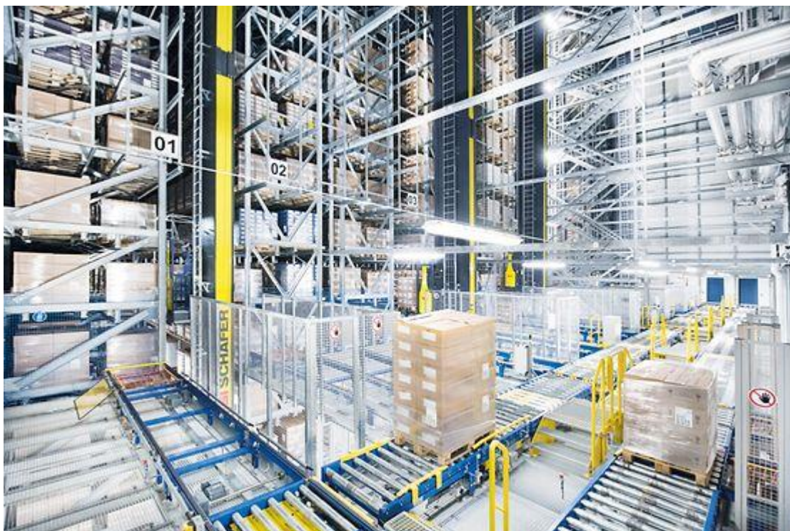
Slika 12. Primjer automatiziranog skladišta (Schaefer)
