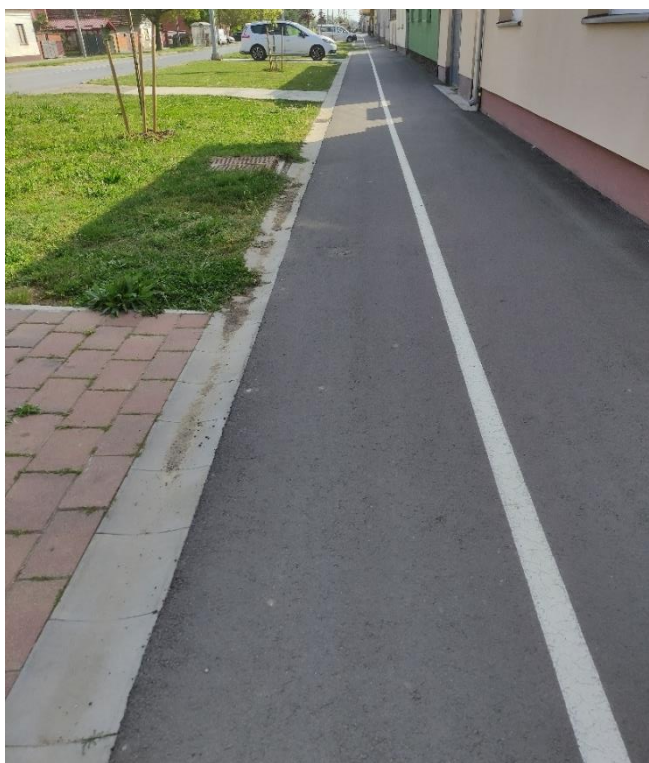
Slika 22. Pravilno održavana horizontalna signalizacija u ulici Vladimira Nazora
