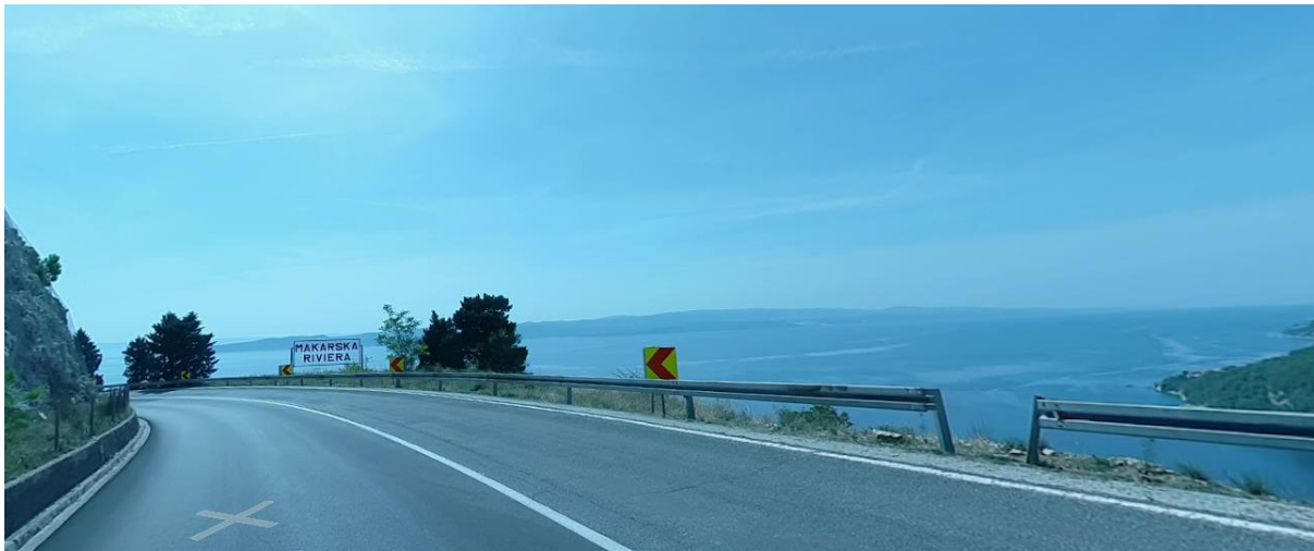
Slika 36. Zavoje DC8 kod naselja Brela gdje je vidljiv nedostatak na zaštitnoj ogradi
