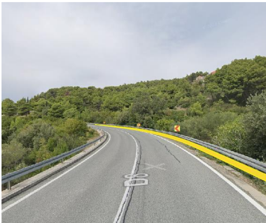
Slika 33. Zavoje na DC8 U mjestu Mala Duba gdje se predlaže postavljanje zaštite od podlijetanja na zaštitnu ogradu
