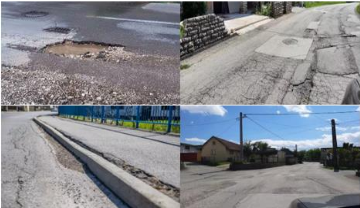
Slika 4. Oštećeni kolnici na području Karlovačke županije
