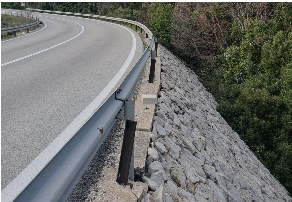
Slika 18. Neuklonjeni nezaštićeni stari stupovi zaštitne ograde
