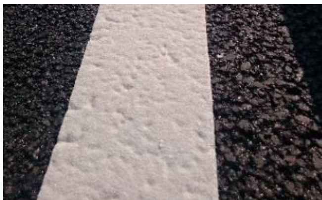
Slika 4. Neprofilirana oznaka na kolniku [2]
