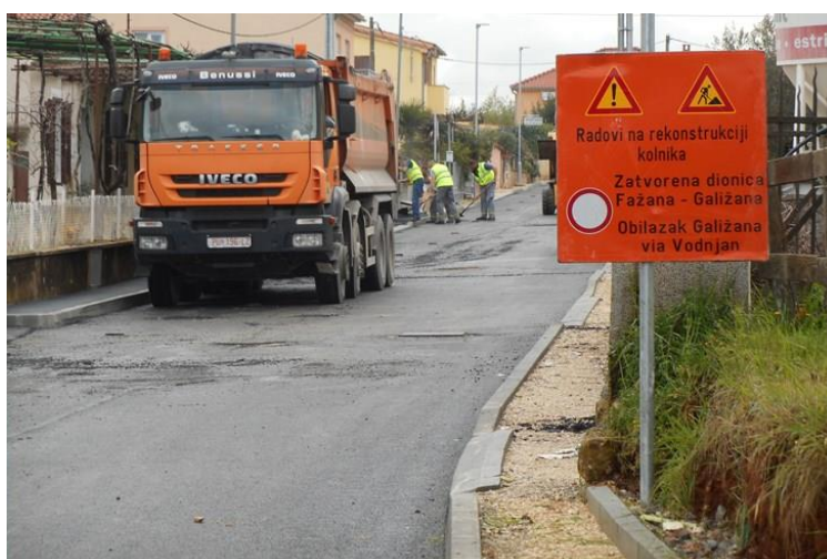
Slika 15: Prometna signalizacije za zatvaranje dionice ceste
