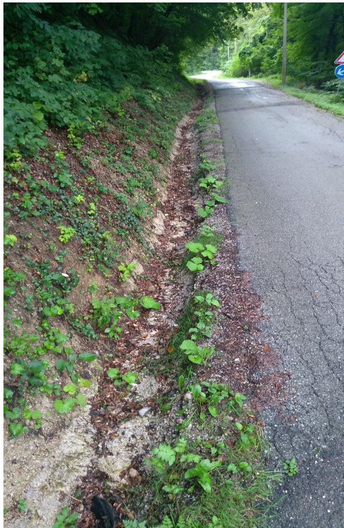
Slika 10. Prikaz neuređenog kanala za odvodnju u mjestu Mali Lipovec
