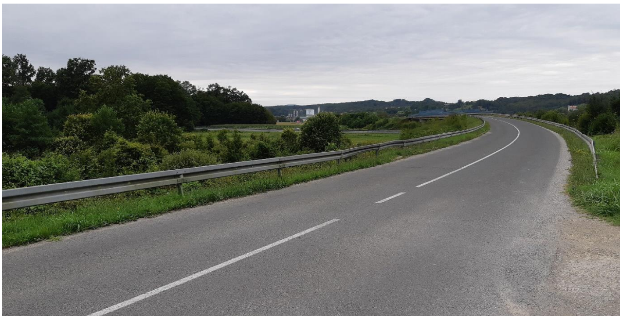
Slika 12. Oštećena zaštitna ograda od ranijih slijetanja vozila na ŽC3036 (Pojatno (Ž2195) – D. Bistra (Ž3007))
