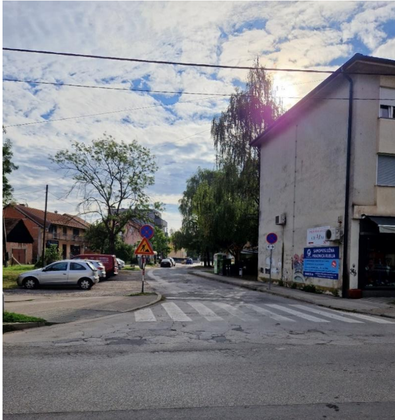
Slika 16. Trenutno stanje kolnika u Kolodvorskoj ulici – kolovoz, 2022. godine
