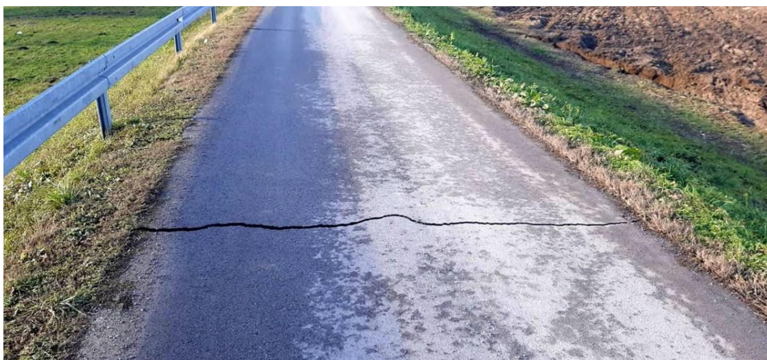
Slika 4. Oštećenje kolnika u mjestu Tišina Erdedska
