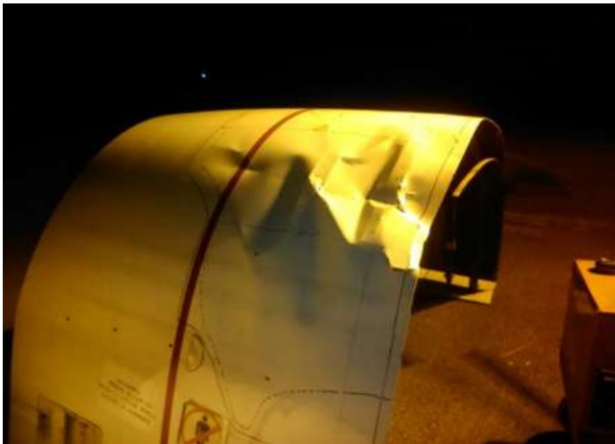
Slika 18. Udubljenja na poklopcu ventilatora, [25]
