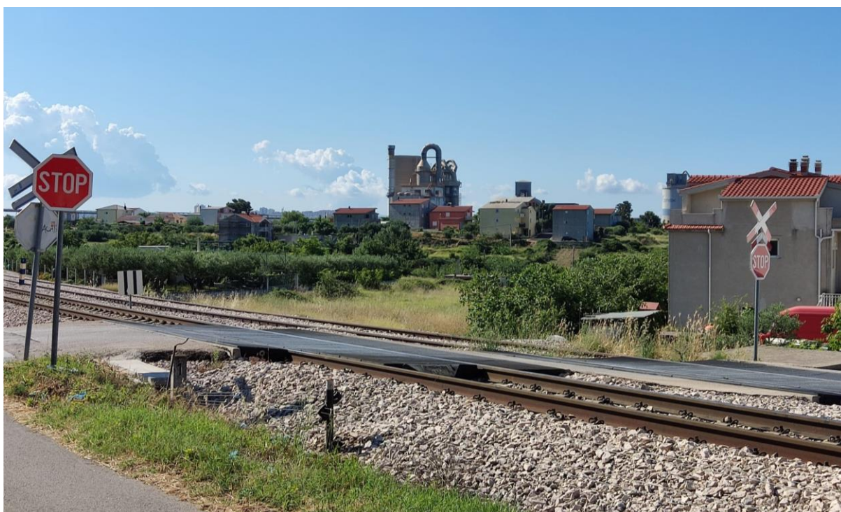
Slika 83. Prikaz stanja gumirane podloge na željezničko-cestovnom prijelazu „Kaštel Sućurac II“
