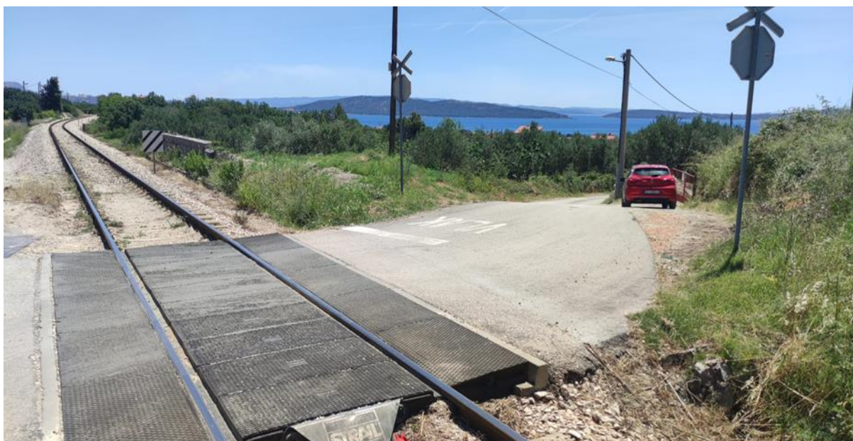
Slika 63. Prikaz stanja gumirane podloge na željezničko-cestovnom prijelazu „Kaštel Lukšić“
