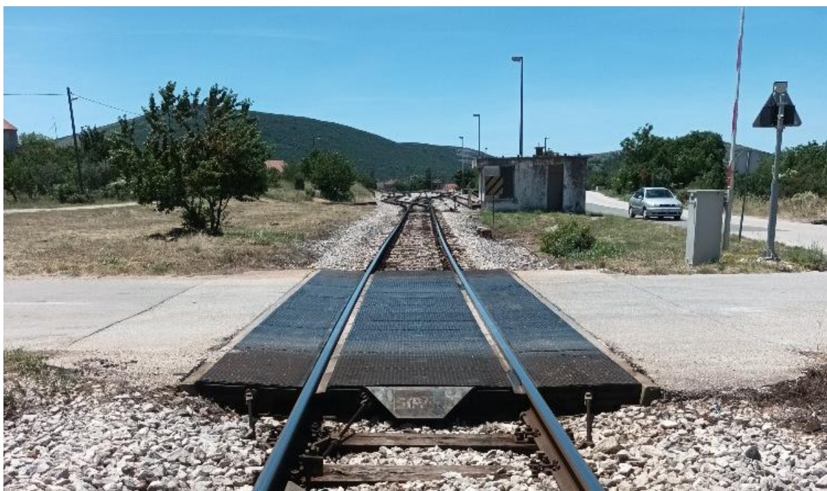
Slika 10. Prikaz stanja gumiranih ploča na željezničko-cestovnom prijelazu „Perkovići“
