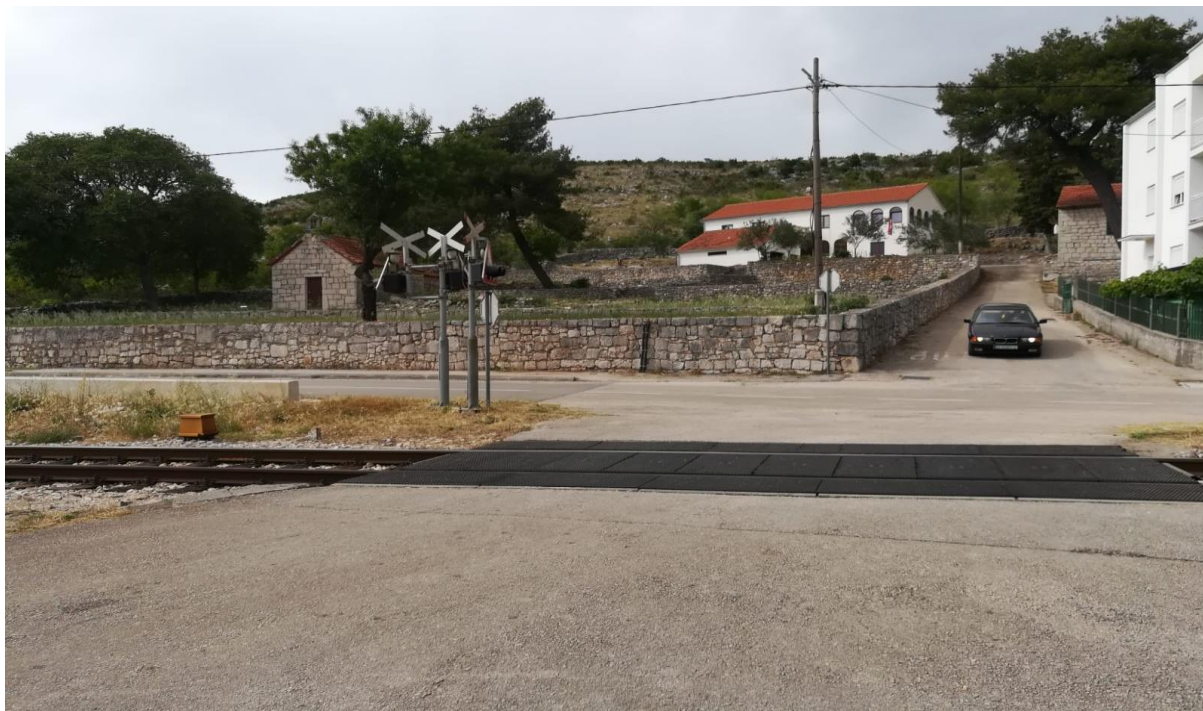
Slika 31. Prikaz stanja gumiranih ploča na željezničko-cestovnom prijelazu „Fratrov“
