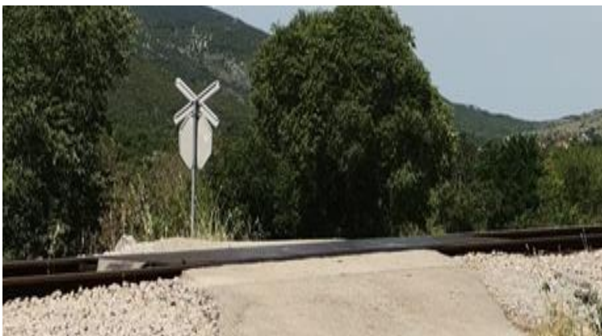
Slika 14. Prikaz stanja gumiranih ploča na željezničko-cestovnom prijelazu „Perlić“
