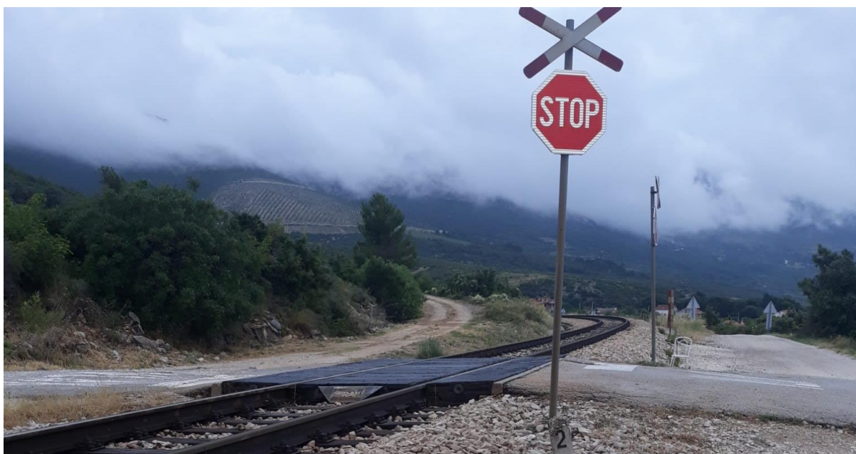
Slika 43. Prikaz stanja gumiranih ploča na željezničko-cestovnom prijelazu „Sadine“
