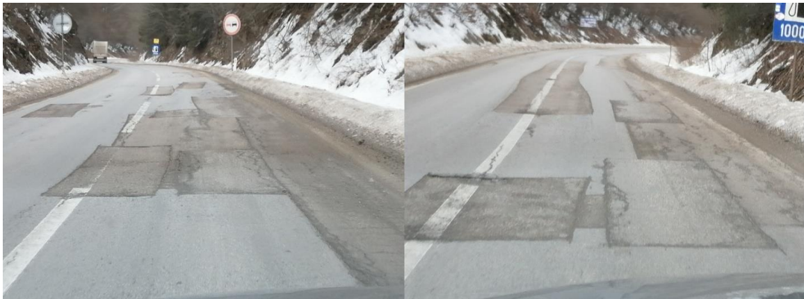
Slika 19. Oštećenja kolničke konstrukcije
