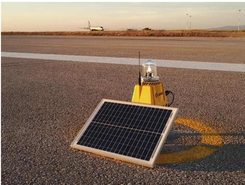
Slika 11. LED rasvjeta sa solarnim sustavom, [65]
