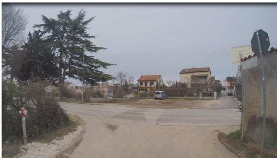
Slika 7. Izblijedena horizontalna signalizacija
