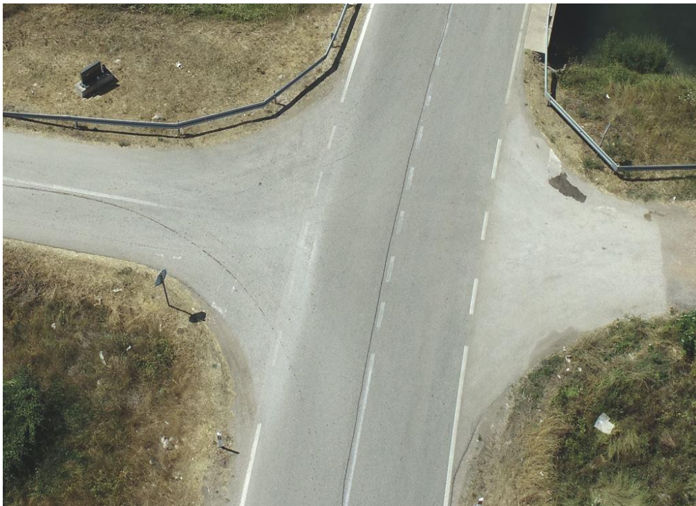
Slika 51 Primjer oštećenja oznaka na kolniku
