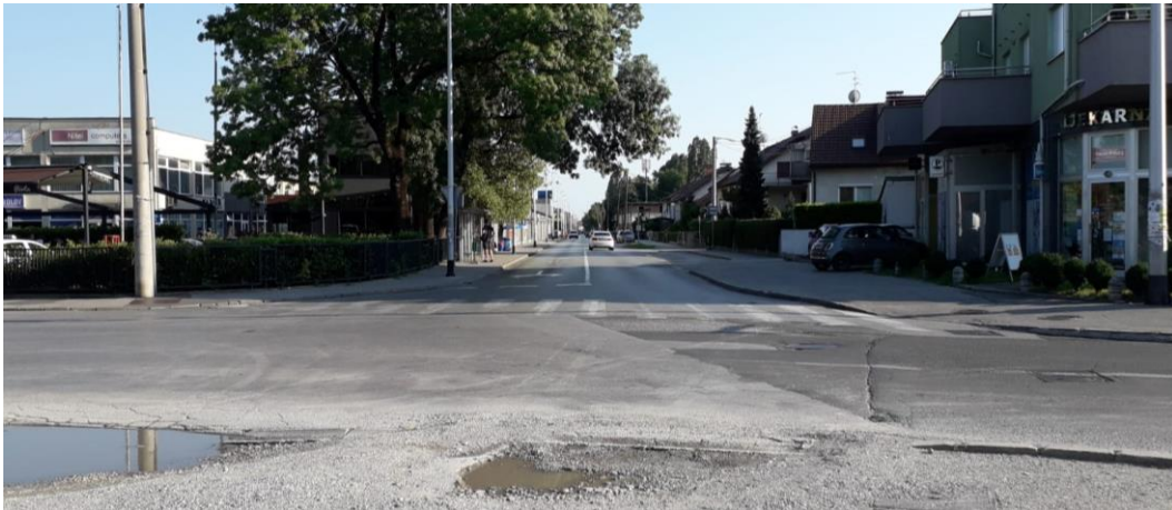
Slika 22. Deformacije na kolniku
