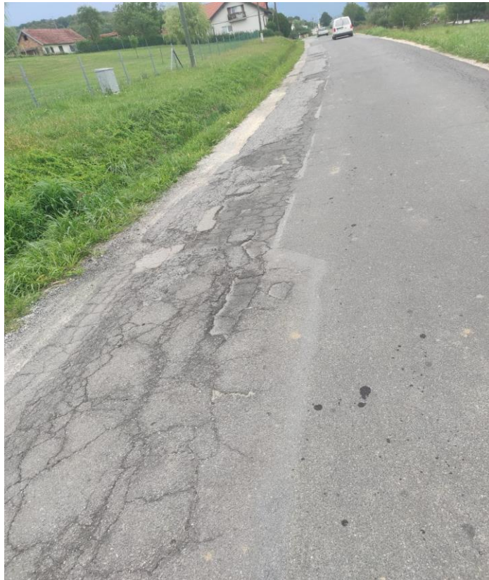
Slika 9. Primjer oštećenja kolnika lokalne ceste LC22053
