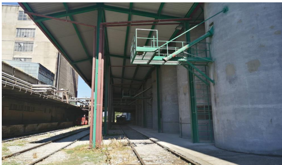
Slika 7 Utovarno mjesto za željezničke vagonne silosa „PIK Vinkovci d.d.“ u Vrapčani (Izvor: Autor)
