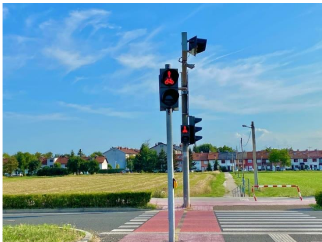
Slika 24. Primjer svjetlosne signalizacije
