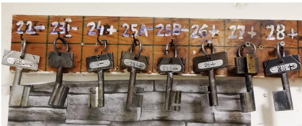
Slika 14. Ključevi skretnica od strane bloka 2
