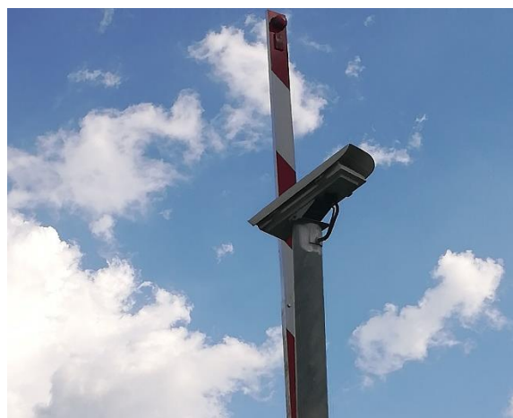
Slika 33. Nadzorna kamera na željezničko-cestovnom prijelazu Poznanovec
