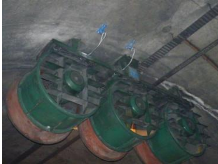
Slika 33. Ventilacija tunela Učka, [3]
