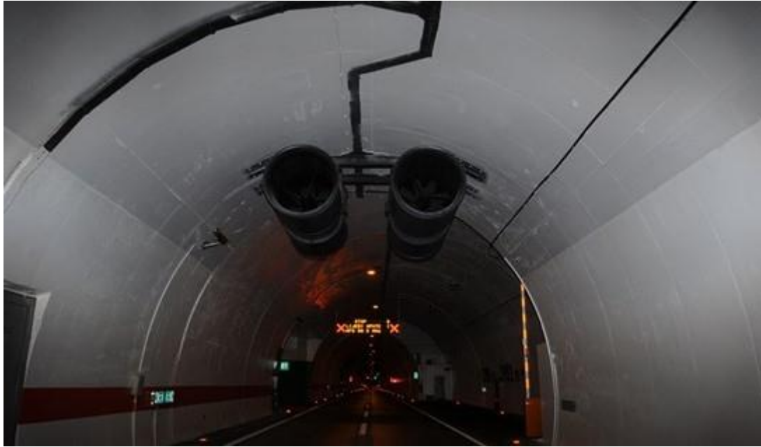
Slika 27. Provjetravanje tunela Mala Kapela, [2]
