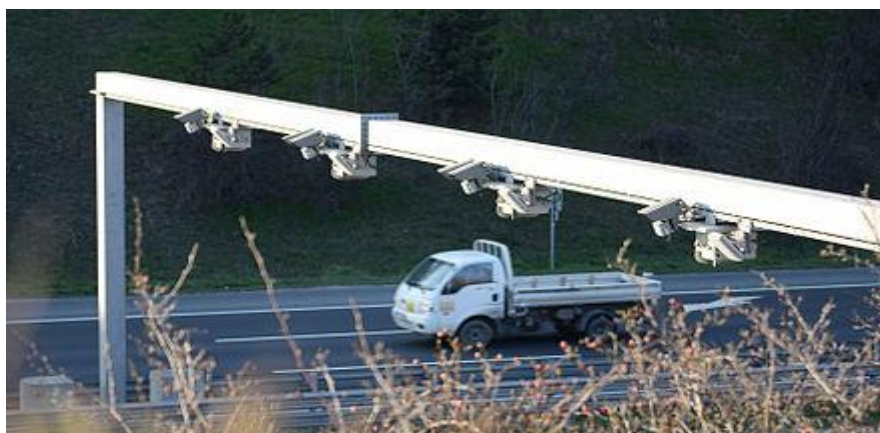
Slika 2. Kamere na portalu na M7 autocesti kod Erd-a, Mađarska
