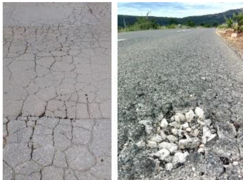
Slika 12. Pukotine na voznoj površini i udarna rupa
