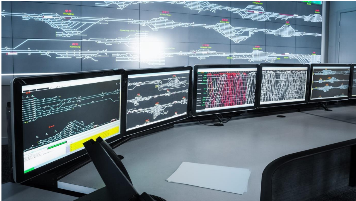
Slika 3. TMS kontrolni ured sa potrebnim sučeljima
