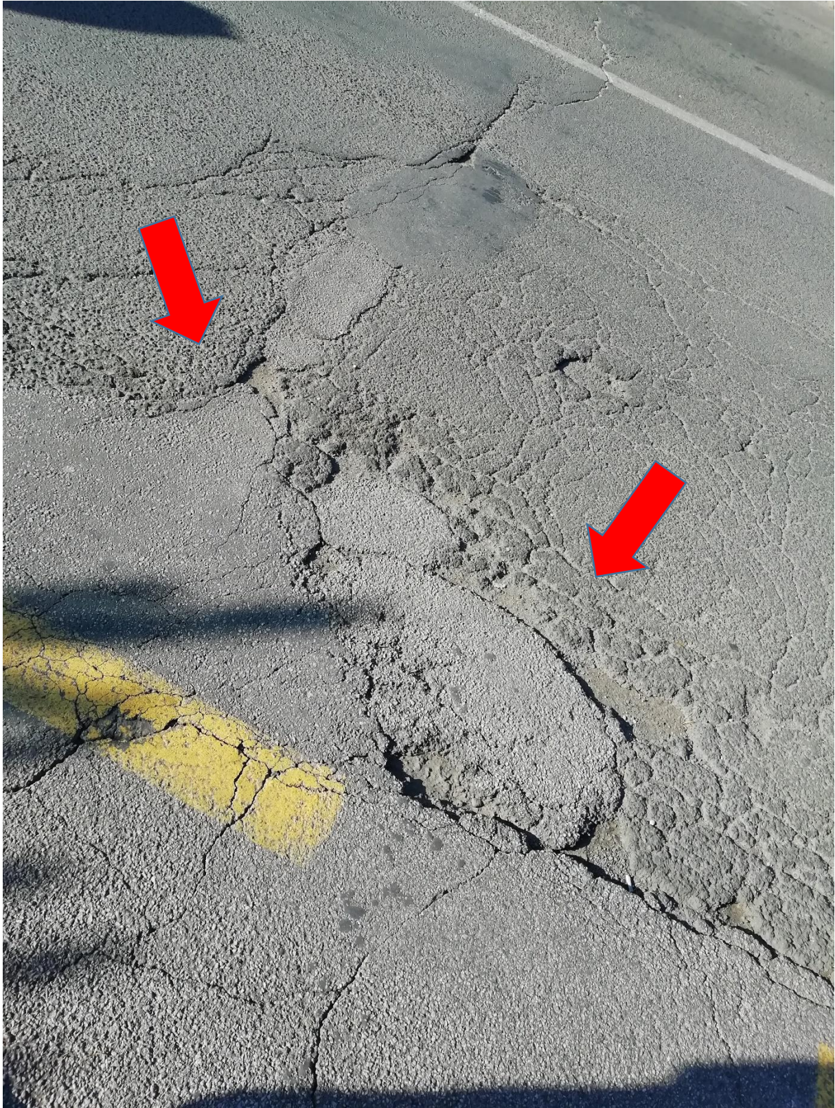
Slika 27. Prikaz oštećenja kolničke konstrukcije
