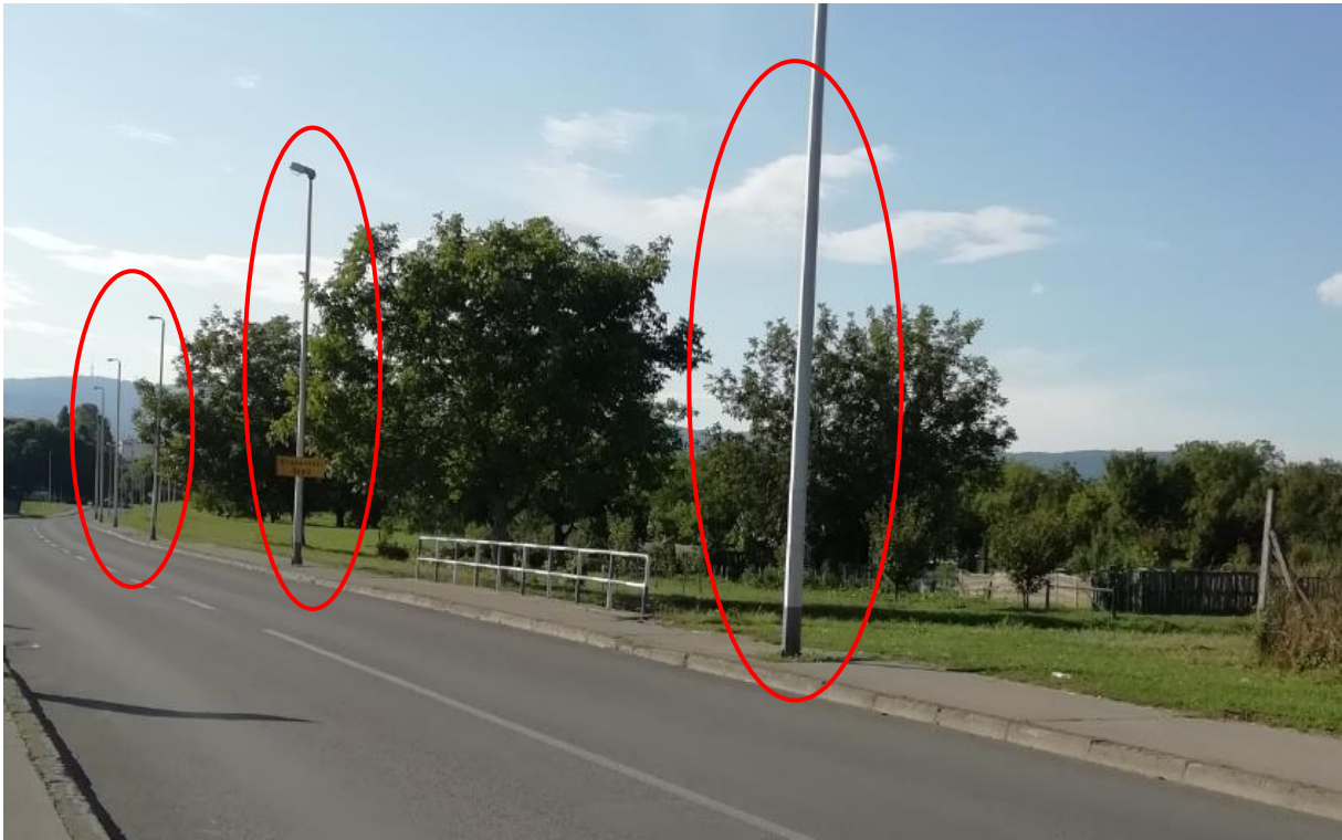
Slika 21. Prikaz potencijalno opasnih stupova rasvjete neposredno uz rub ceste na Raskrižju 2
