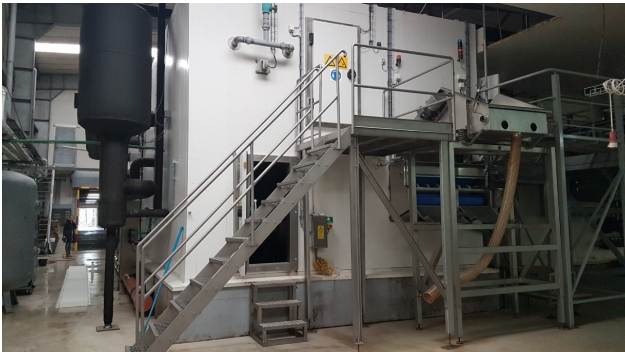
Slika 56 Tunnel za zamrzavanje robe
