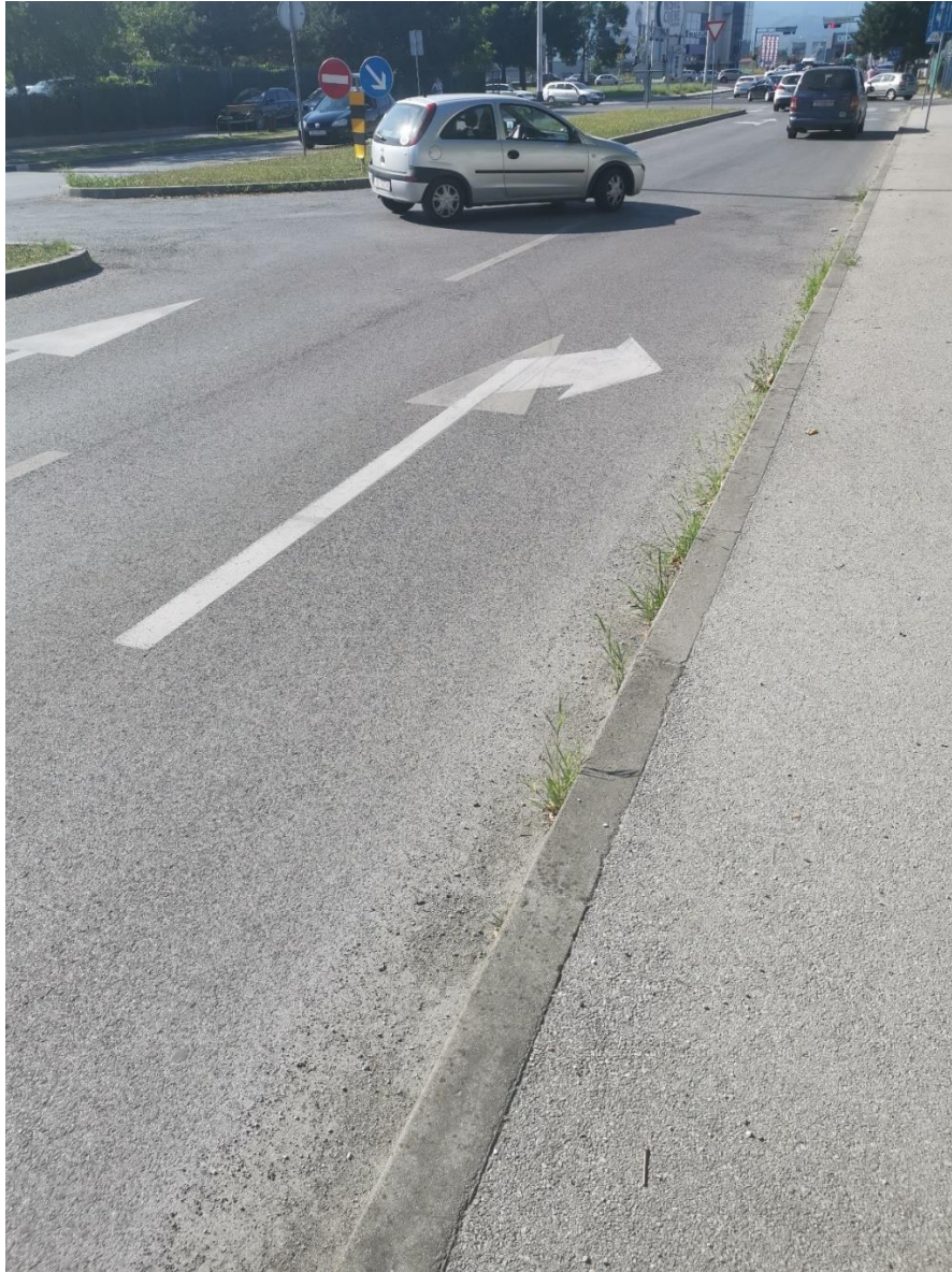
Slika 9. Neadekvatno uklonjena stara signalizacija na sjevernom privozu (2)
