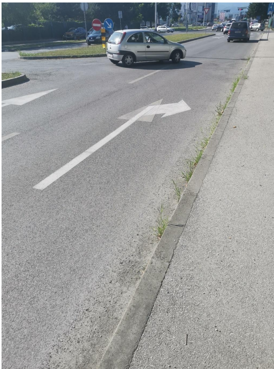
Slika 9. Neadekvatno uklonjena stara signalizacija na sjevernom privozu (2)
