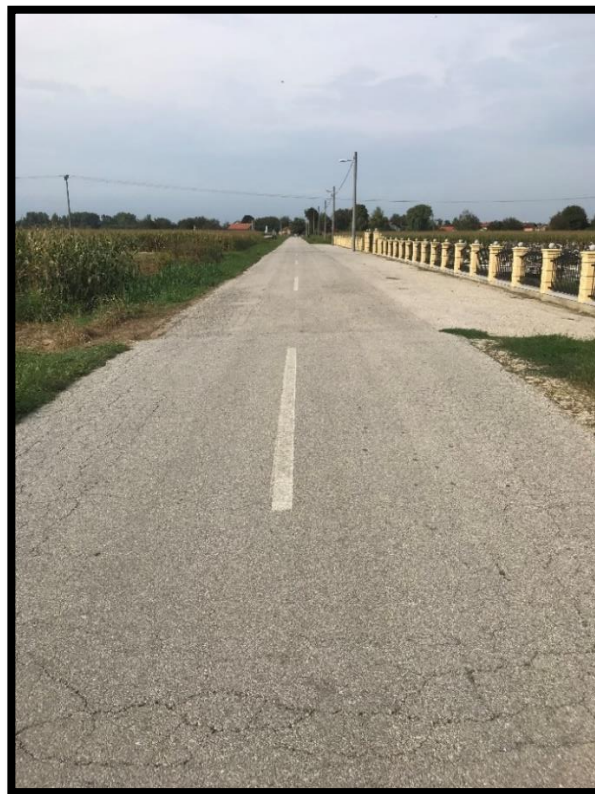
Slika 27. Postojeće stanje kolnika LC25103
