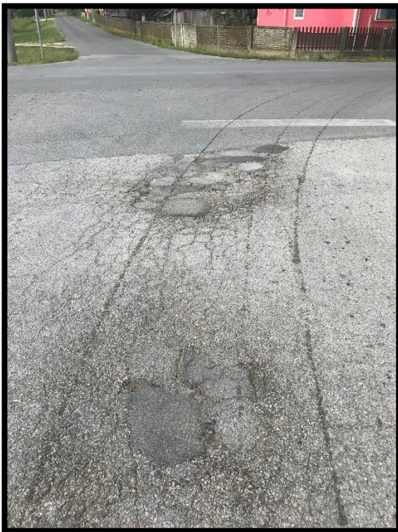
Slika 15. Prikaz oštećenja na kolniku
