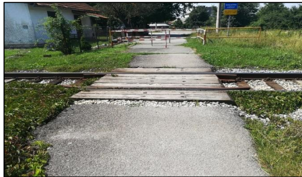
Slika 123. Prikaz stanja drvenih pragova na željezničko-cestovnom prijelazu „Ulica Mladosti“
