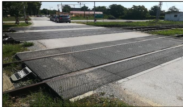
Slika 107. Prikaz stanja gumirane podloge na željezničko-cestovnom prijelazu „Mrkšina“
