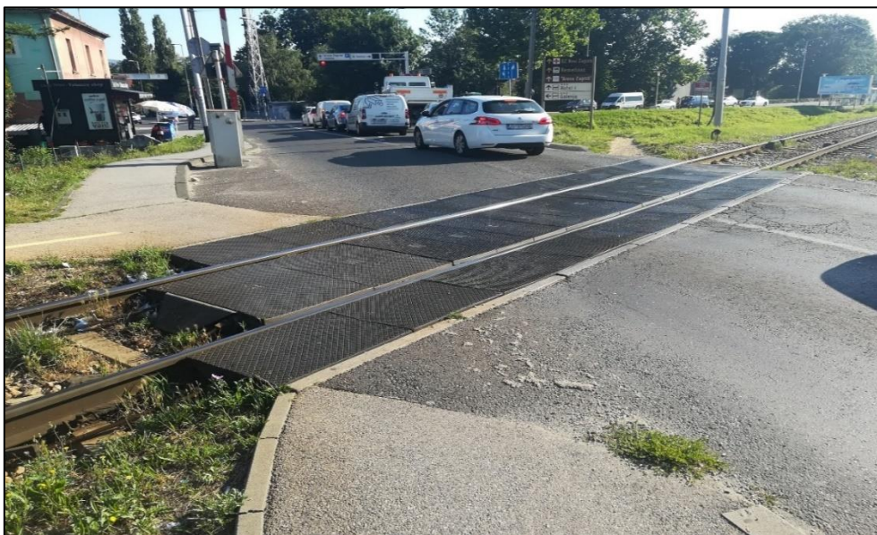
Slika 31. Prikaz stanja gumiranih ploča na željezničko-cestovnom prijelazu „Remetinec“
