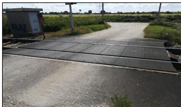
Slika 87. Prikaz stanja gumirane podloge na željezničko-cestovnom prijelazu „Žižići“
