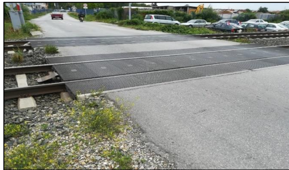
Slika 51. Prikaz stanja gumirane podloge na željezničko-cestovnom prijelazu „Staklana“
