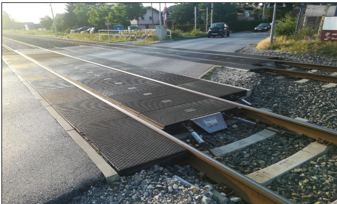
Slika 14. Prikaz stanja gumiranih ploča na željezničko-cestovnom prijelazu „Osječka“
