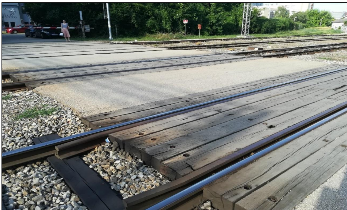
Slika 18. Prikaz stanja drvenih pragova na željezničko-cestovnom prijelazu „R. Austrije“
