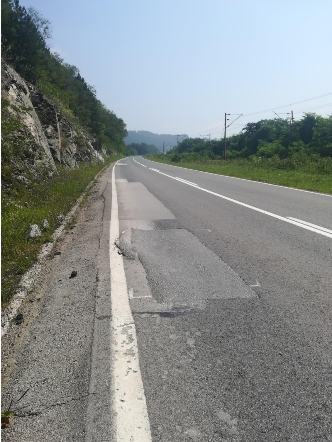
Slika 8. Oštećenje kolničke konstrukcije
