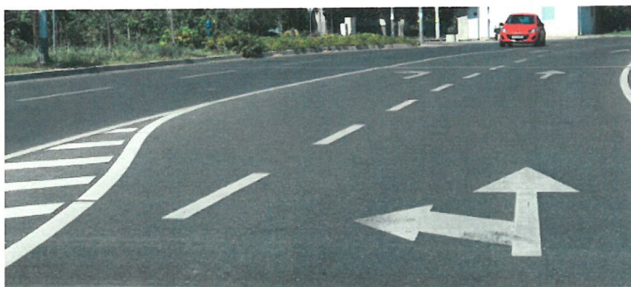
Slika 48. Primjer izvedbe uzdužne oznake na kolniku tip H02 u Ulici Siniše Glavaševića
