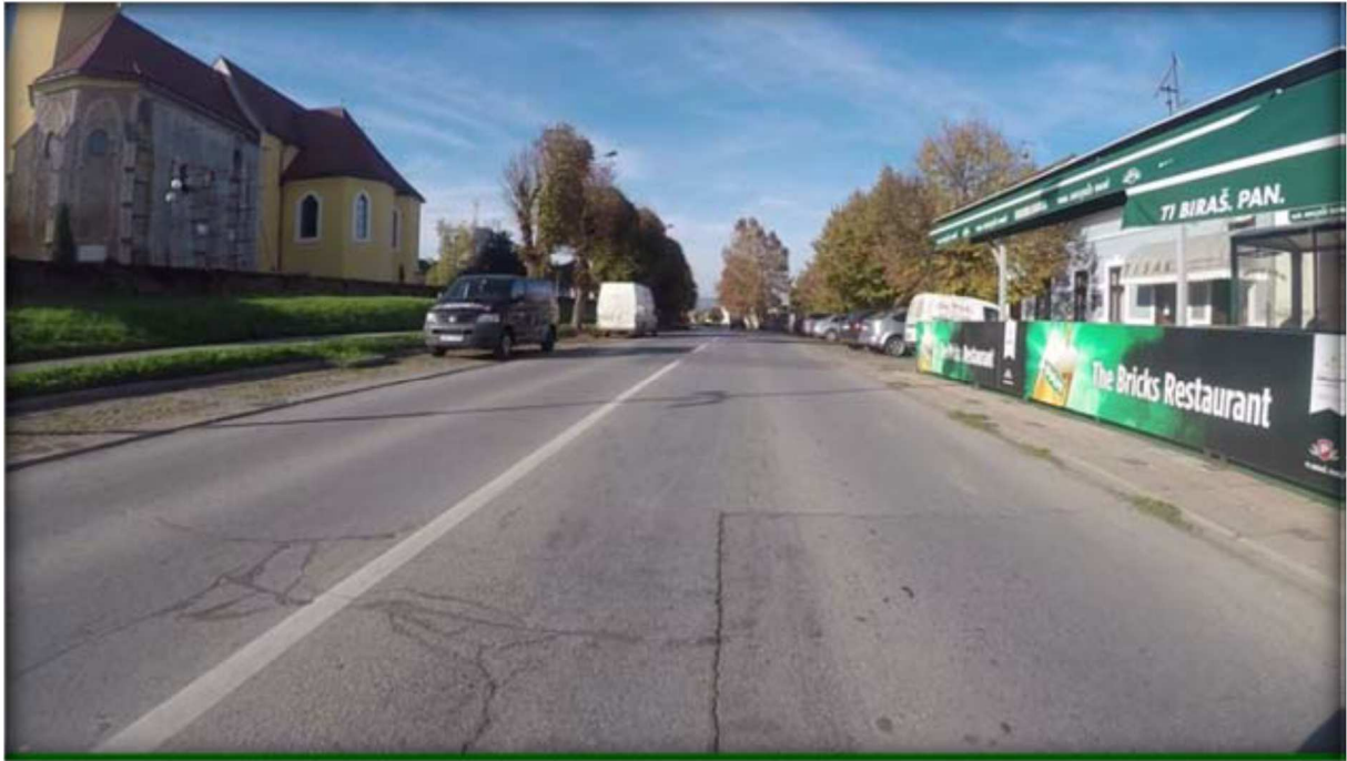
Slika 10. Prikaz pukotina na Trgu dr. Franje Tuđmana
