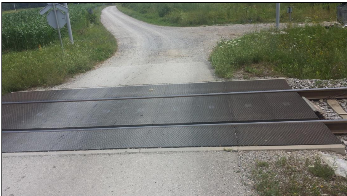
Slika 18. Prikaz stanja podloge na željezničko-cestovnom prijelazu „Peščenica“
