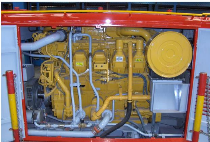
Slika 17. Diesel motor CAT 3508 B DITA SCAC
