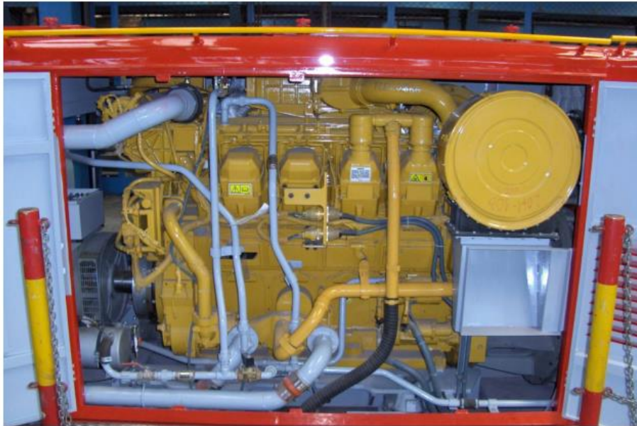
Slika 17. Diesel motor CAT 3508 B DITA SCAC
