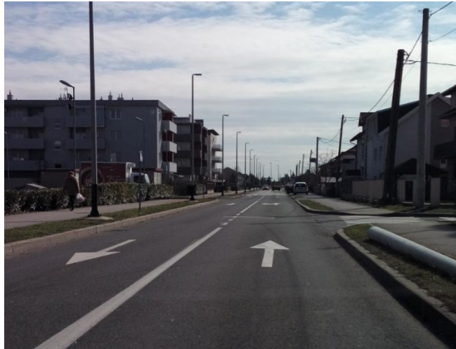
Slika 62. Nepotrebno iscrtana strelica na kolniku
